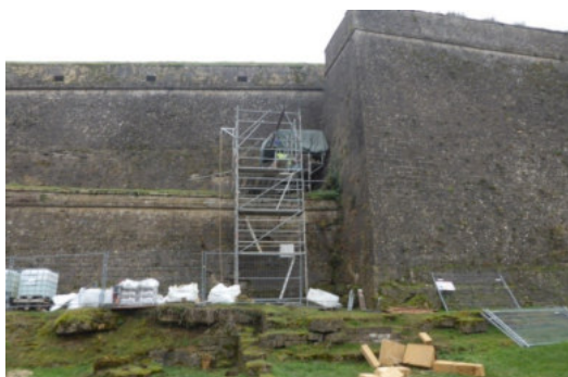
La citadelle de Montmédy a réalisé en 2020 sa 28 ème tranche d'entretien des remparts
